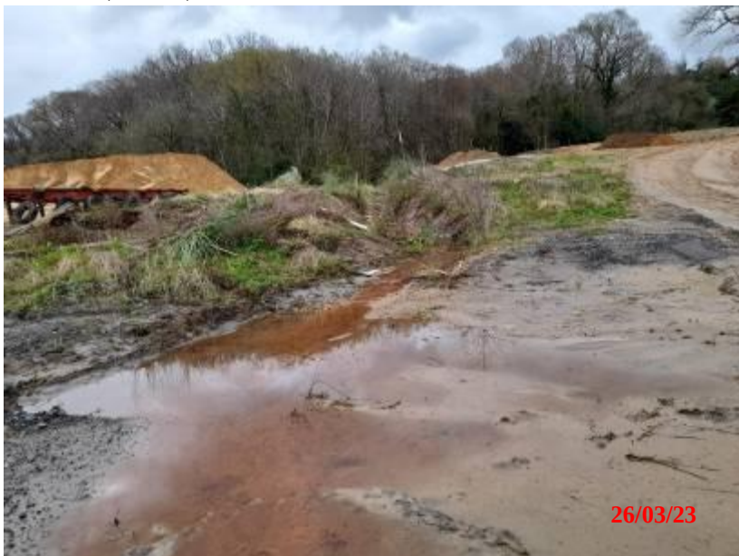
Photo 10 filet d'eau ferrugineuse traversant N/S
