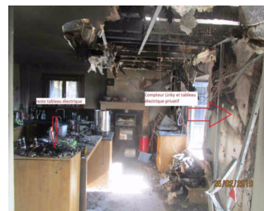
Photo extraite du rapport d'expertise sur l'incendie de Langoiran.
