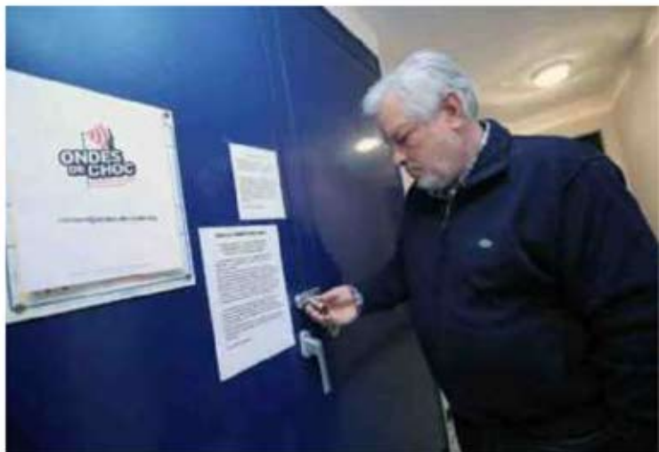
Pierre Nicot a cadenassé l'accès à ses compteurs. PHOTO E.D.
