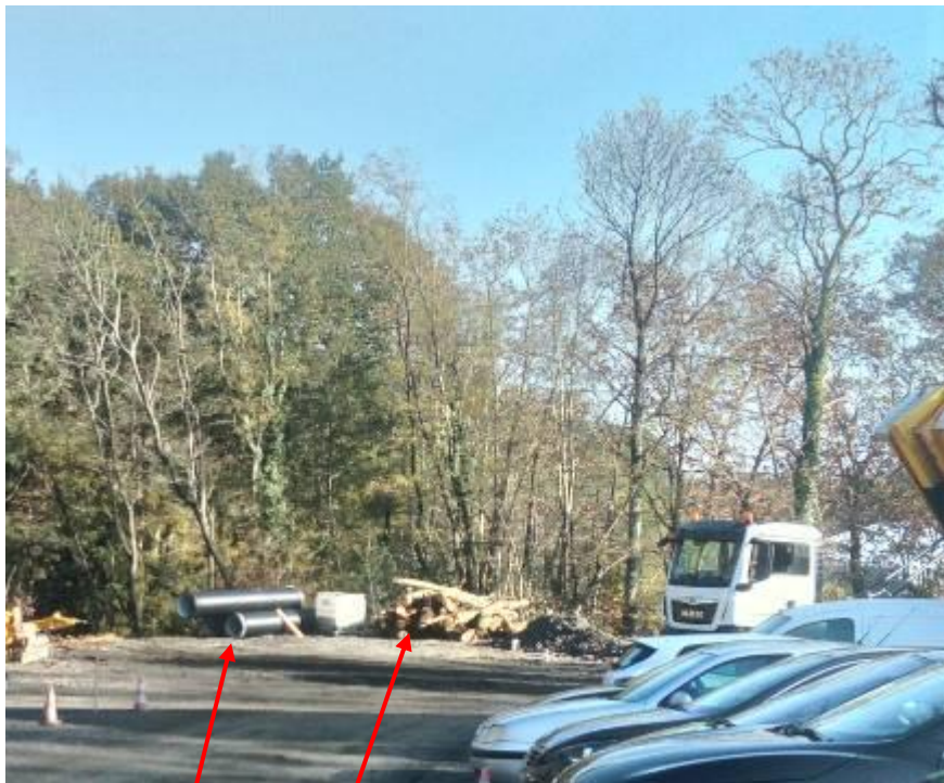
Buse de drains et bois coupé à l'intersection des parcelles 116 et 763
